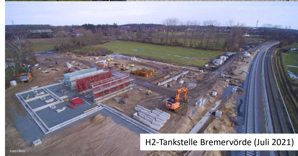
Provisorische H2-Tankstelle Bremervörde
